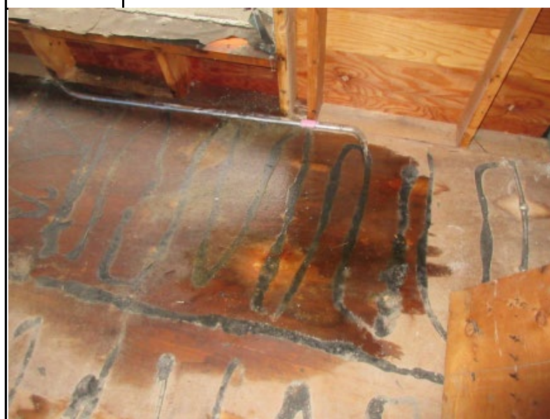
漏水箇所発見
