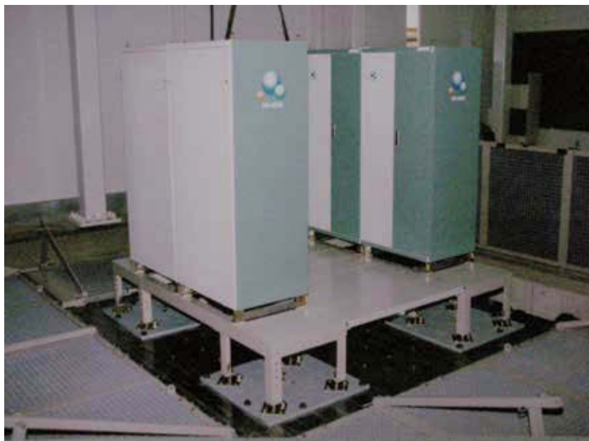
耐震試験に使用される通信機室二重床架台
